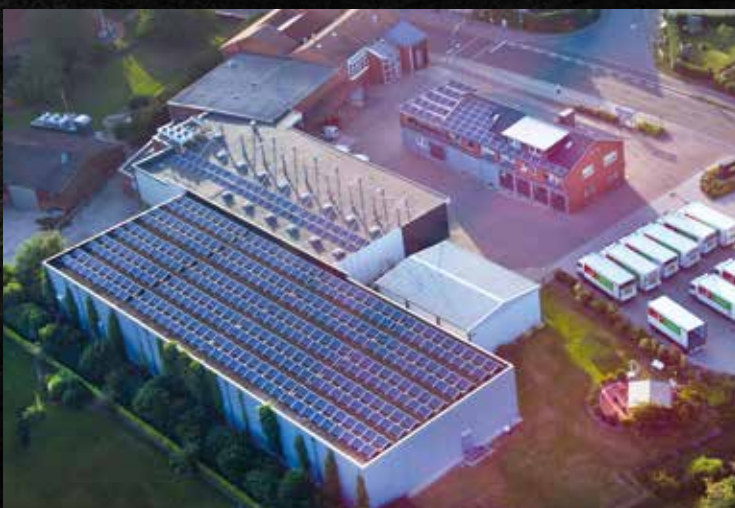
Luftbild des Betriebes Wetschen mit der installierten Photovoltaikanlage
